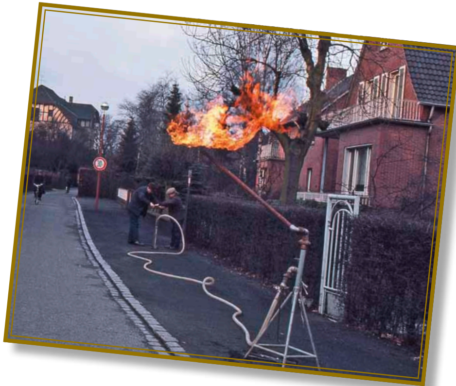
Bevor das Erdgas durch die Leitungen strömte, wird wie hier im Südtal das alte Stadtgas abgefackelt.
